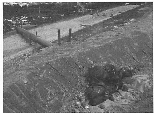
写真-7 沈殿池に濁水を流す管
