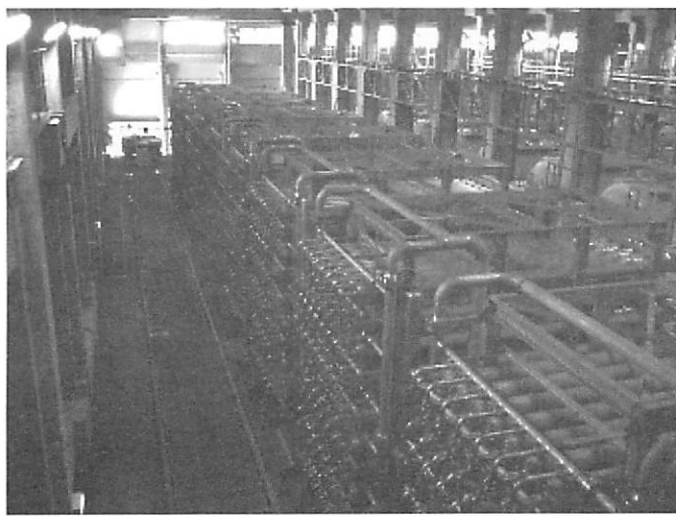
写真-8 逆浸透膜
