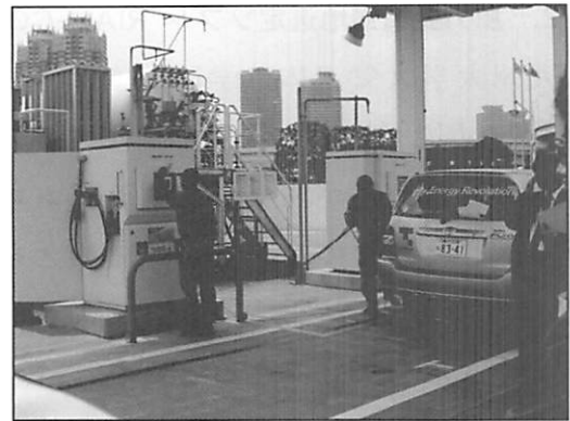
写真-2 JHFC 有明水素ステーション
