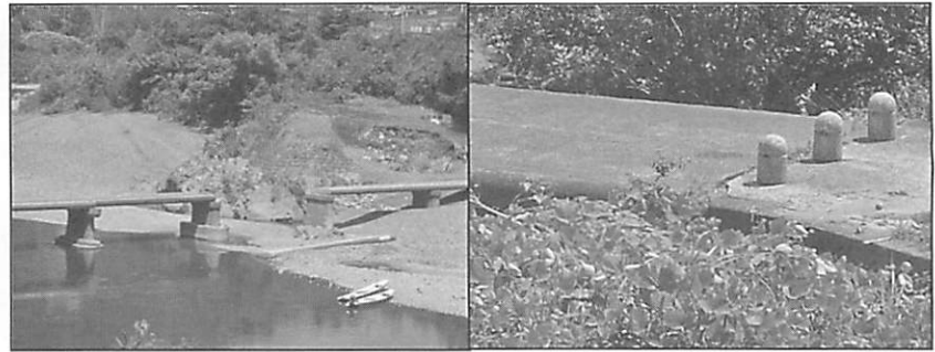
図-19 半家橋の落下箇所と止め具
