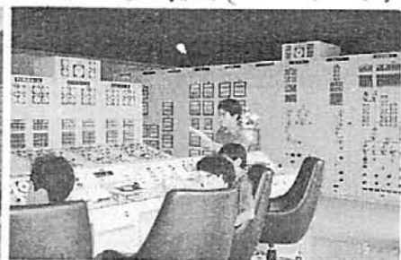
発電所の集中制御室
