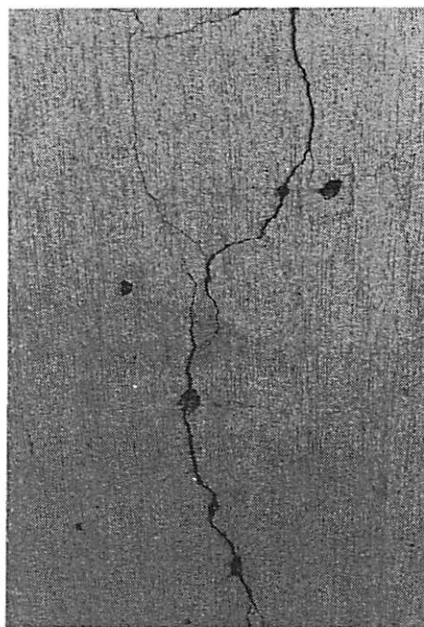
図-10：拘束方向に走る大きなひびわれ
