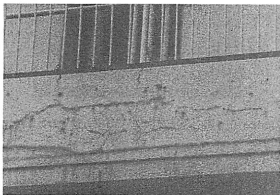
図-12：ベランダのひびわれ
