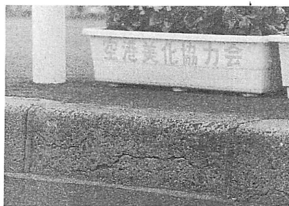
図-15：道路縁石のひびわれ
